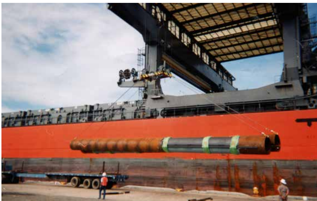
Descargando los pilotes de 90' de largo para la construcción del Parque Lineal en San Juan, el 10 de agosto de 1997
