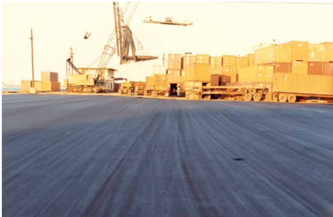
Reparación del Muelle C en el Terminal de San Juan, entre 1992 y 1994
